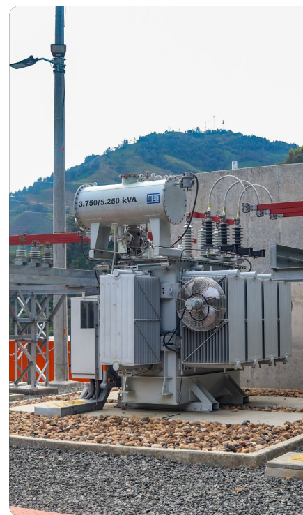
Subestación digital, Cajamarca, 2022. Fotografía: Celsia.
