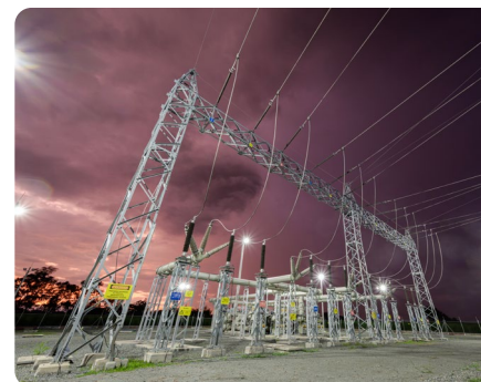
Subestación Las Palmas, Valle del Cauca, 2025. Fotografía: Celsia.
