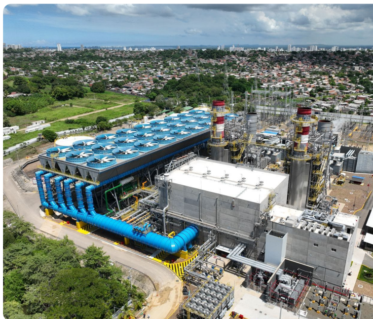
Termocandelaria, Bolívar, 2025. Fotografía: Termocandelaria.
